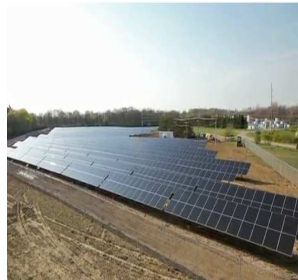
Solution d'alimentation électrique pour une centrale solaire à Dayton, Ohio
