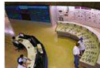
Systèmes de contrôle commande (DCS)
