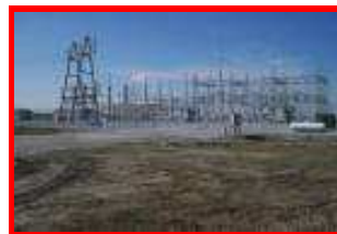
Canada Sous-station Riel
