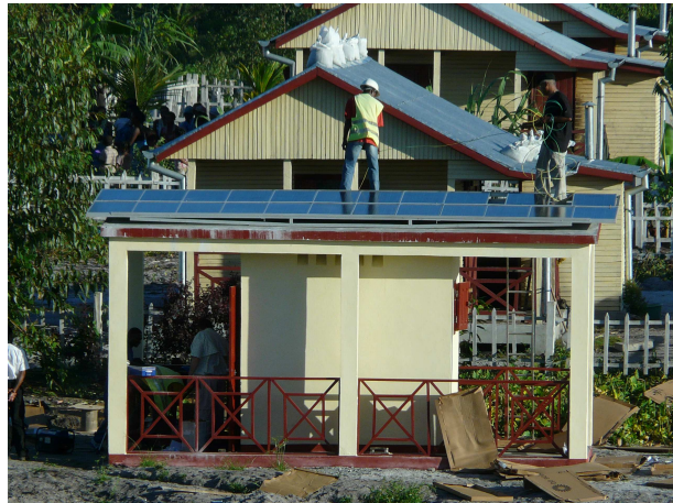
L'expertise photovoltaïque de Schneider Electric en cours de déploiement sur le site de Marovato (Madagascar).
