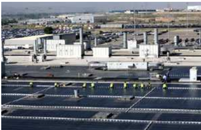
La plus grande ferme solaire du monde sur le toit d'une usine, près de Saragosse (Espagne), équipée d'une solution Schneider Electric
